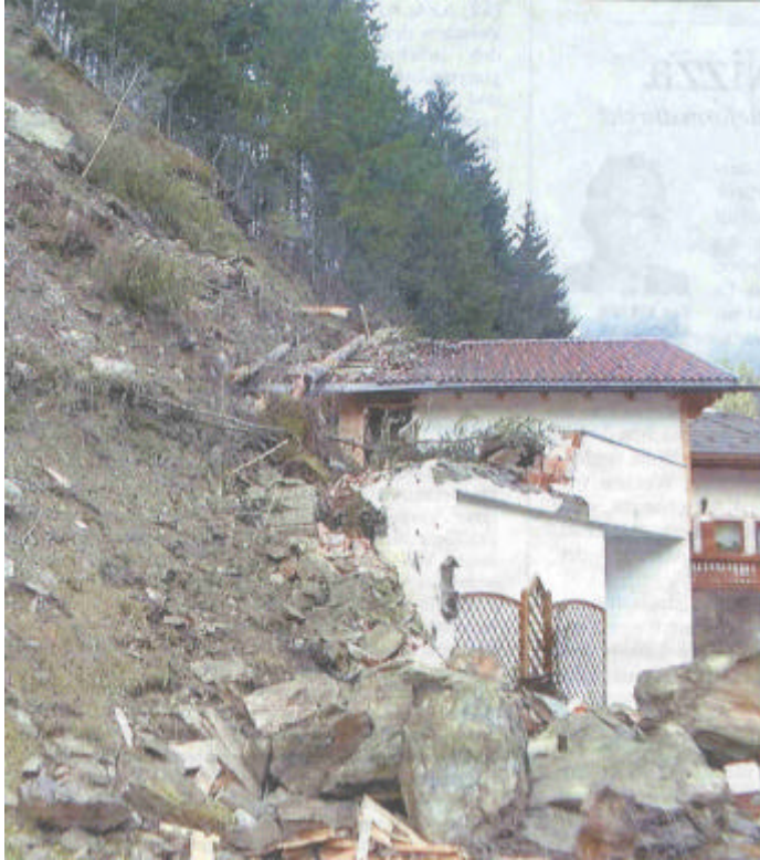
Foto 2: Hangrutschung und Felssturz bedrohen ein Wohnhaus.
